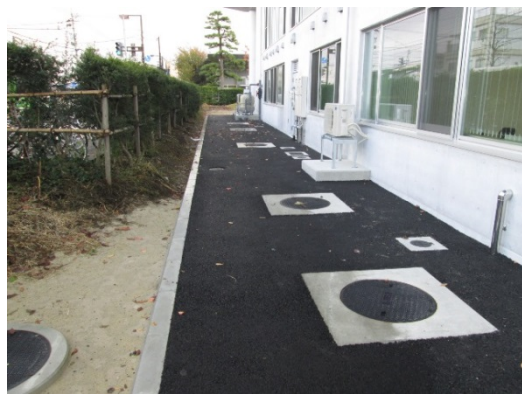
非常時トイレとして使用できる マンホールトイレ用のマンホール の設置
