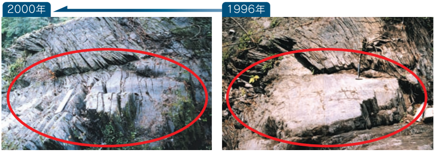
開いた割れ目が目に見えて発達。豪雨で前の河川が荒れ、河川沿いの岩盤が侵食されたことにつかえがなくなり、急激に変形が進行した 元々垂直な構造を持つ岩盤が、重力の作用で谷側(左側)へたわんでいる状態。長い期間を経て、緩慢に岩盤が変形してきた結果だ
