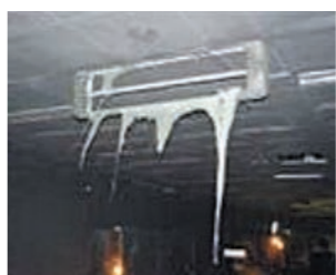
火災煙によって破損した避難誘導灯 一般的に使用されている非常照明用器具や避難誘導灯が保証している周囲温度は140℃だが、火災時に天井に溜まる煙は短時間でそれ以上に達する場合もある
