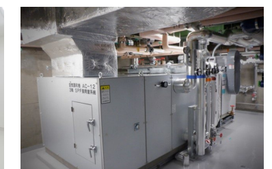
3階空調機械室
