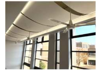
天井送風機 (シーリングファン)
