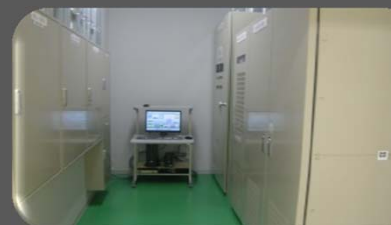
完成写真（電気室）
