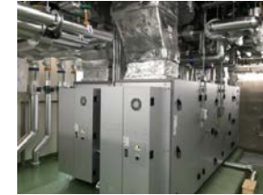
1階空調機械室
