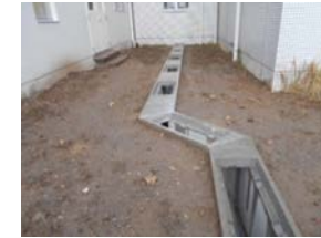
蓋を外した状態
