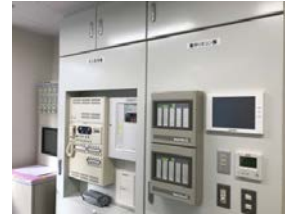
1階管理室 (防災監視盤・集中リモコン盤)
