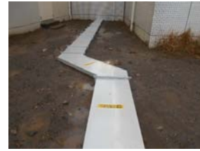
R I排水屋外配管(点検用側溝)
