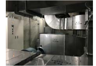
R階排気機械室
